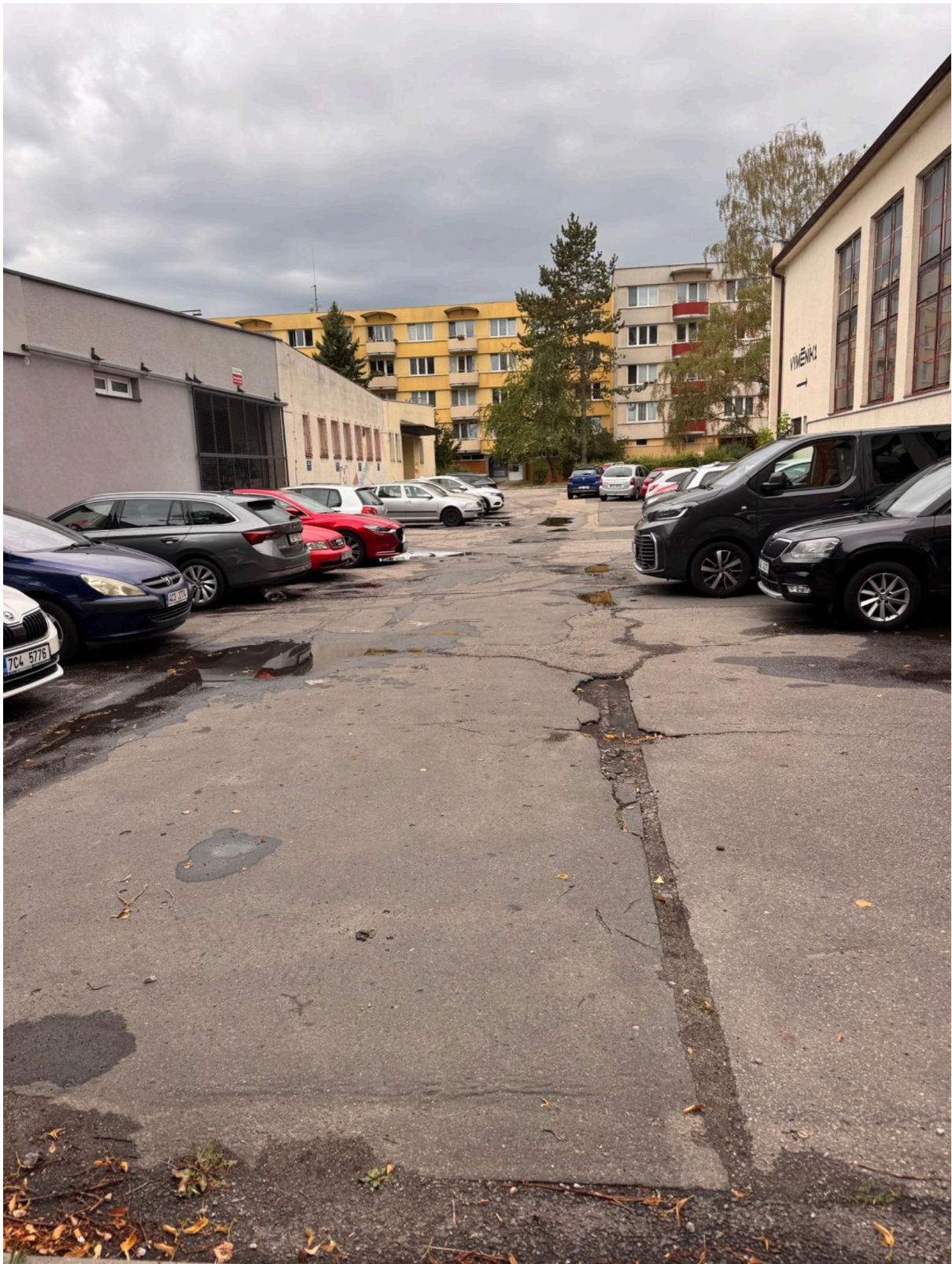
Alt Text: na fotografii je povrch parkoviště (se zaparkovanými auty), asfaltový povrch je nerovný, s prasklinami a v některých místech s dírami
